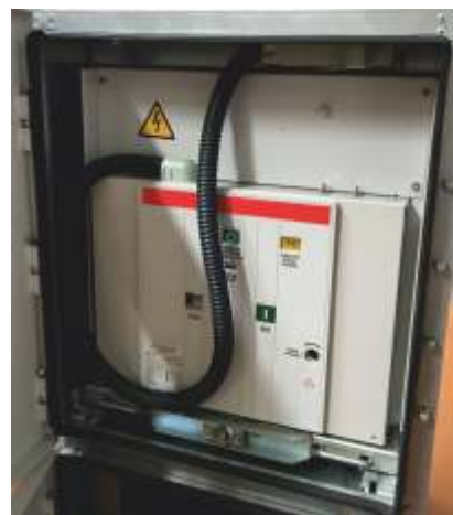
Рис. 4.2 Отсек выкатного элемента
