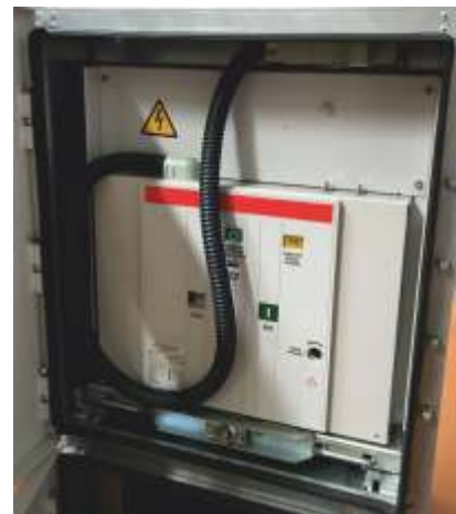
Рис. 4.2 Отсек выкатного элемента
