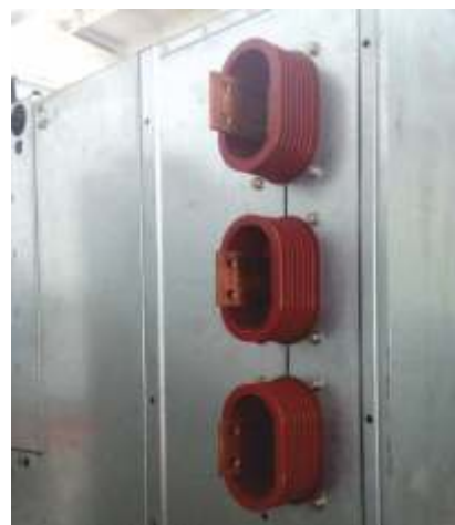
Рис. 4.1 Отсек сборных шин шкафа КРУ
