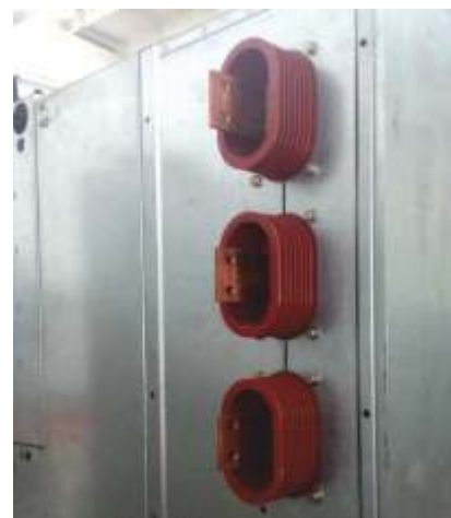
Рис. 4.1 Отсек сборных шин шкафа КРУ
