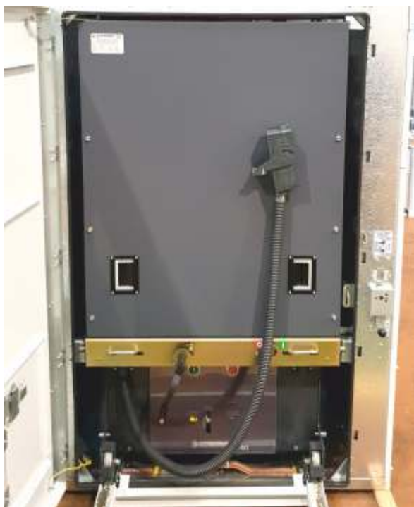
Рис. 3.1. Выкатной элемент с силовым выключателем в контрольном положении
